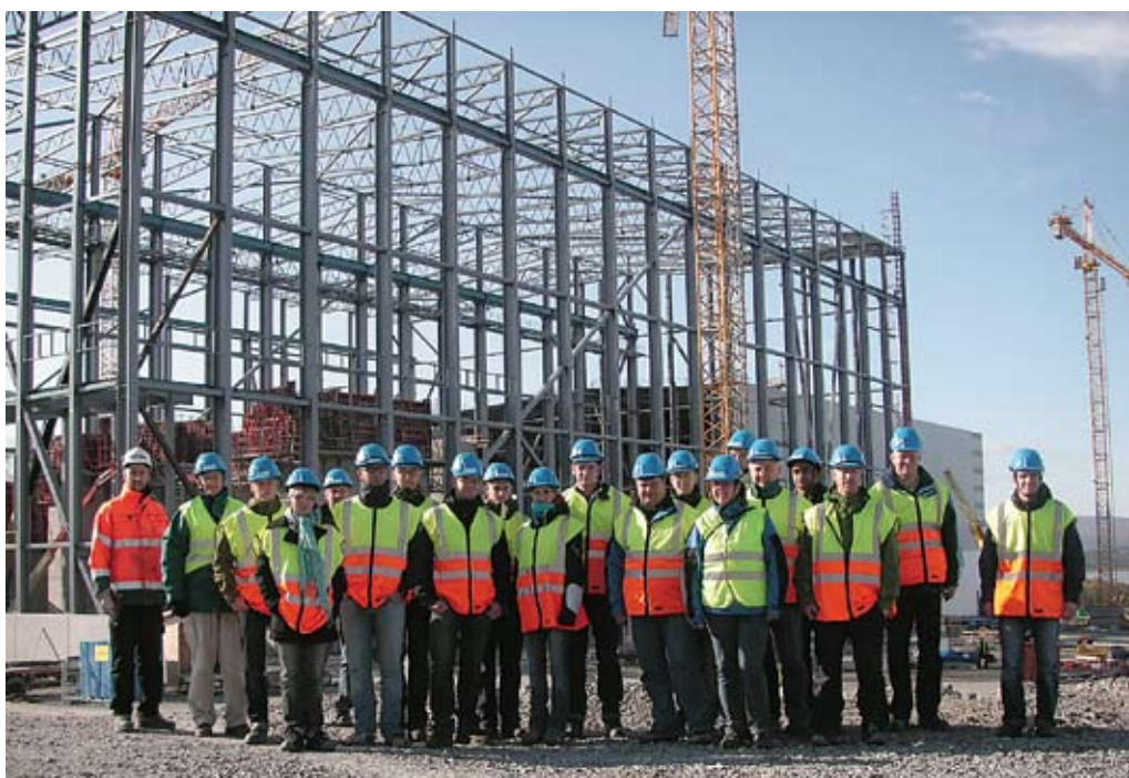
Det är ett stort gäng som arbetar med Aitik-projektet – ett av de största stålbyggnadsprojekten i Europa. 500 byggnadsarbetare är anställda i projektet och minst lika många jobbar på olika håll i världen med konstruktion, utrustning och maskiner. Däribland Kadesjös.
