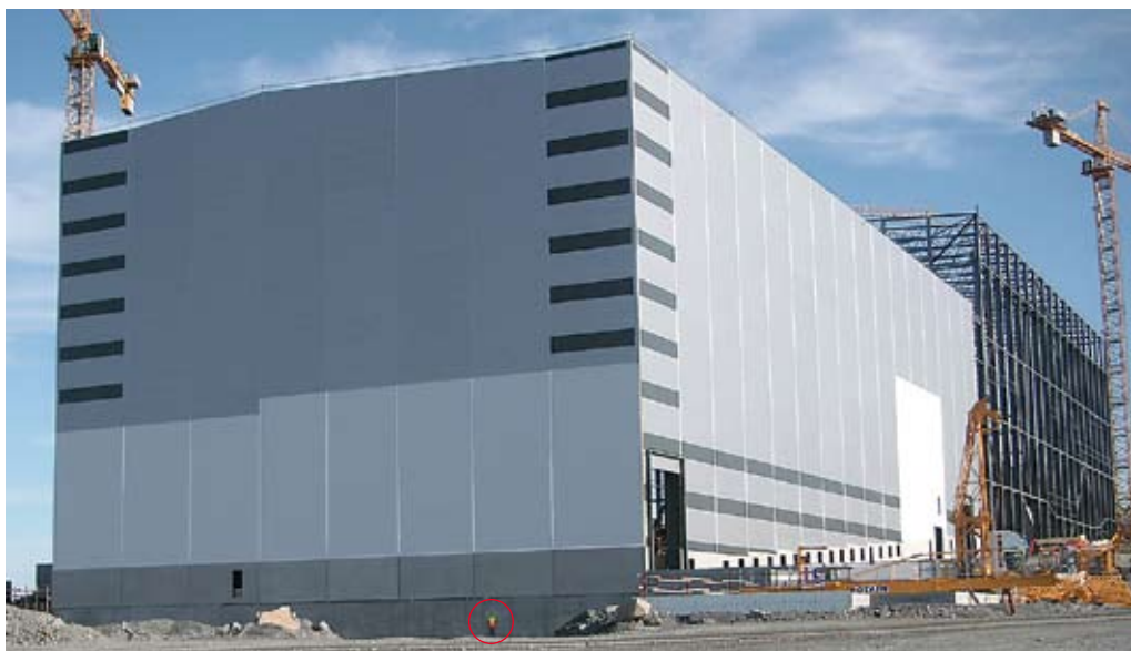
Det nya anrikningsverket är redan ett landmärke som syns väl från luften när man går in för landning på Gällivares flygplats. Observera en Kadesjöare (inringad) som står intill grundsockeln till den väldiga byggnaden.
